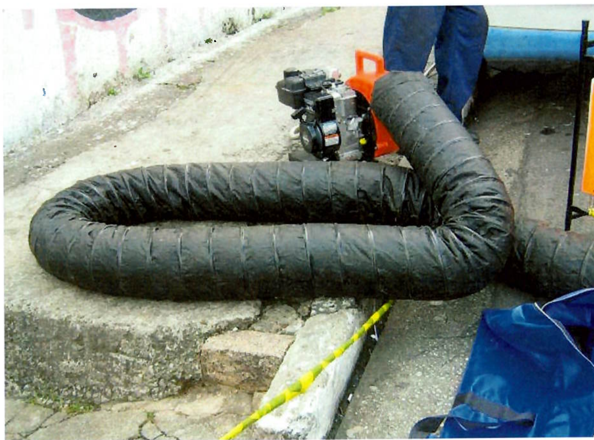
Figura 02 - Utilização do insuflador e/ou exaustor de ar ligado, com a mangueira de maneira inadequada (dobrada).
