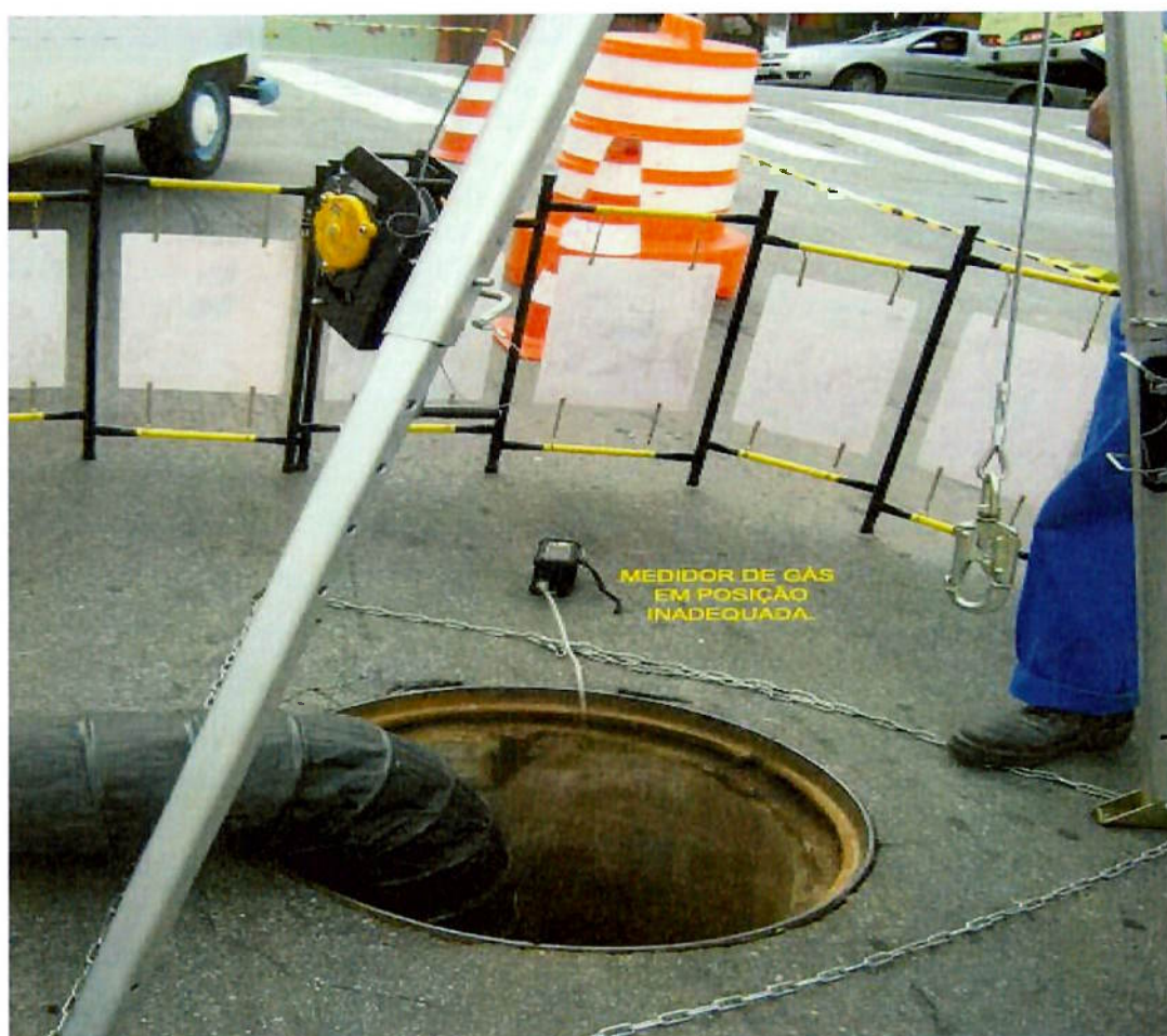
Figura 03 - Mangueira do Insuflador e/ou exaustor de ar. Utilização inadequada do aparelho de monitorar gás.
